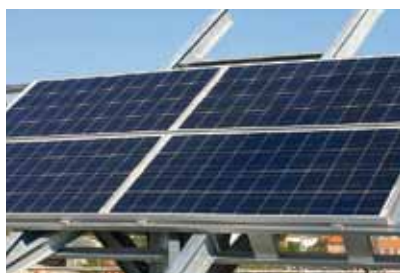
Photovoltaikanlagen spielen eine wichtige Rolle im Netz der Zukunft
